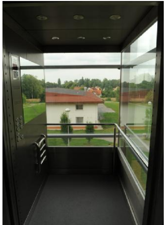
Domov důchodců Neratovice – OTI 630/0,69
